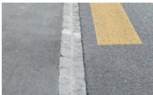
Kleine Niveaudifferenzen beim Abgang auf die Fahrbahn bei Querungen.
